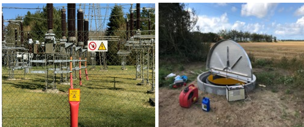
Figur 4.16 Eksempelfoto af markeringspæl og linkboksbrønd
