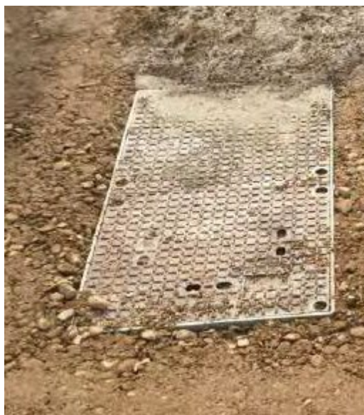
Figur 4.3. Eksempel på fiberbrønd i terræn.
